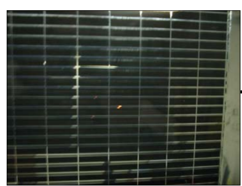
PANELES FOTOVOLTAICOS SEMITRANSSPARENTES FUNCIONAMIENTO DE LAS PLACAS FOTOVOLTAICAS UBICADAS EN LA CUBIERTA DE LA PLAZA
