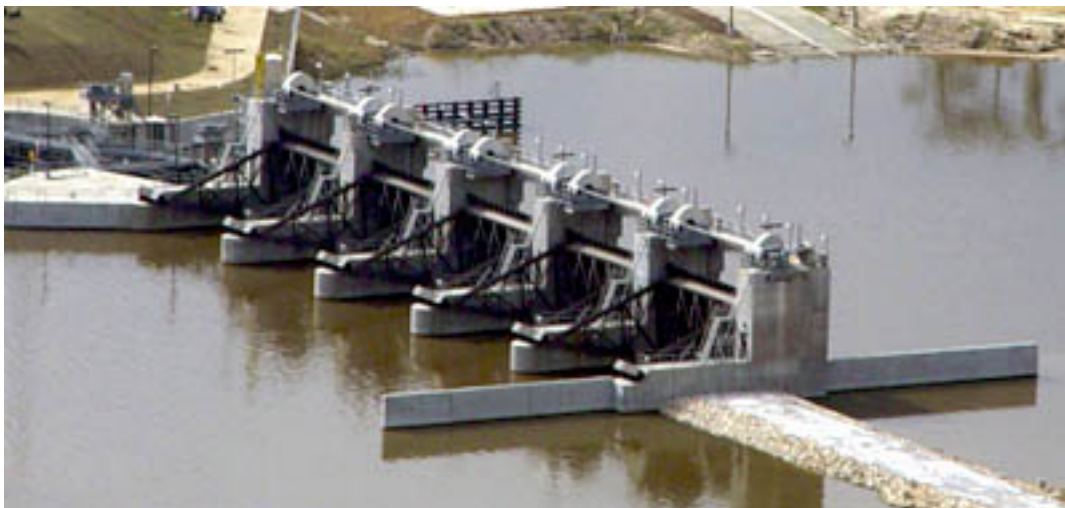
Figura 7.2.2.5: Barrera antisal en el río Neches. Cuenta con un paso lateral para embarcaciones. Es una de las pocas barreras antisal de compuertas presentes en el mundo, ganadora del premio al mejor proyecto de restauración ambiental en 2003 por el US Army Corps of Engineers.
