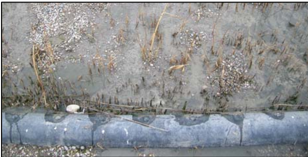
Fig. II.6 Tub de distribució de l'afluent situat a la superfície de l'aiguamoll i ocupant l'ample de la zona d'entrada d'aquest (EDAR de Verdú, Lleida)
