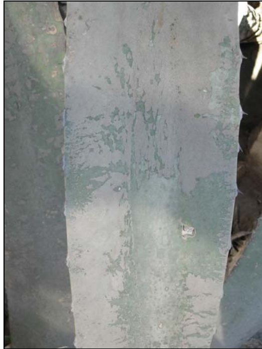
Fotografía 12. Detalle de incrustaciones debidas a la contaminación. Carretera C-31
