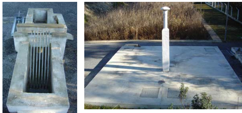
Fotografía 16. Obra de entrada y fosa séptica de Fataca.
