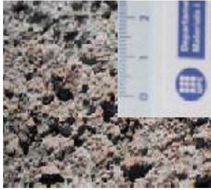
Figura E.3 Rugosidades en la superficie de la losa
