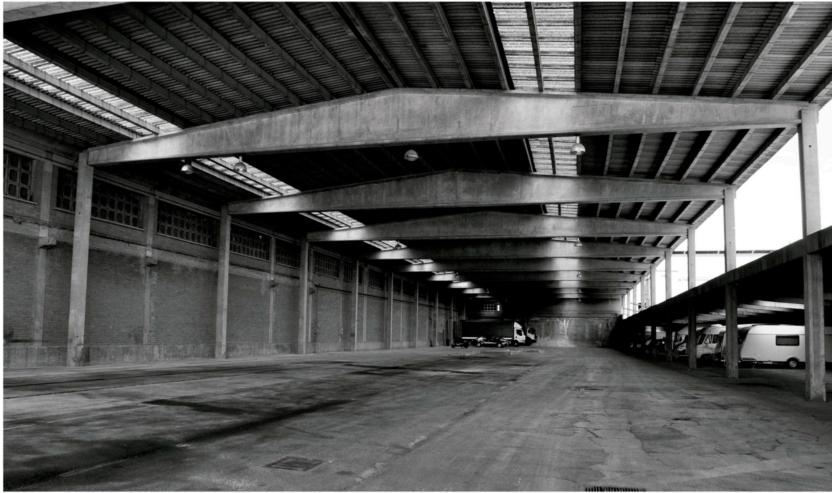
Nave central actual de la fábrica, en la actualidad está totalmente en desuso, el único uso ocasional que se le otorga es el de aparcamiento de vehículos, camiones, caravanas... la nave acaba en un muro sin conexión con la parte superior.
