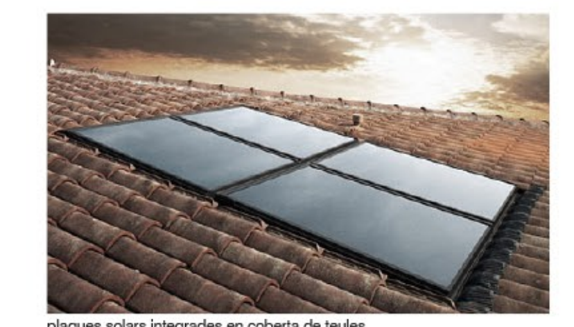
plaques solars integrades en coberta de teules
