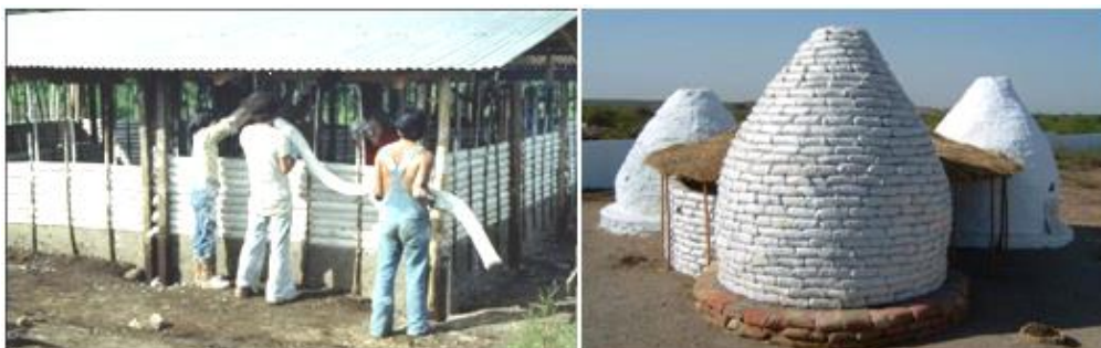
Figura 2.4 Estructura de planta rectangular ejecutada con muros de earthbag continuo, Guatemala 1977 (izquierda) y Domo a partir de sacos individuales, Anon 2007 (derecha)
