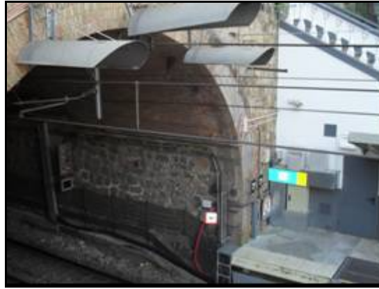
Foto 18: Ejemplo de canalización por túnel en estación FGC de La Floresta(Fuente: Eva Aranda)
