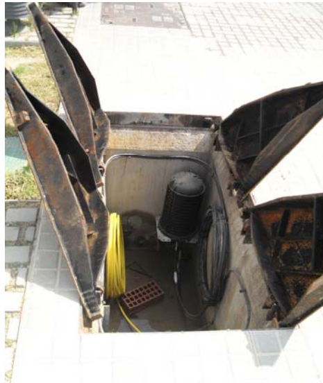
Foto 7: Ejemplo de arqueta de registro de operador de Telecomunicaciones (Fuente: Fibra y Sistemas. S.L.)
