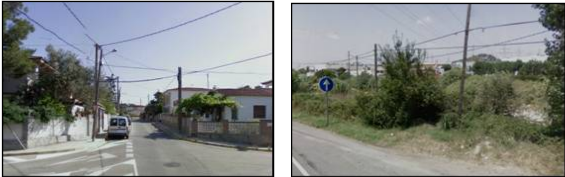
Foto 23: Ejemplo de tendido de fibra óptica a través de postes (Fuente: Eva Aranda)
