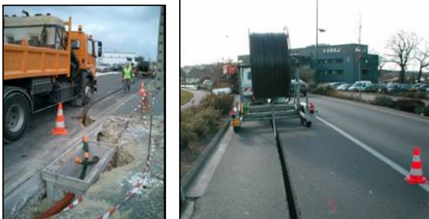
Foto 11: Instalación de registro intermedio de hormigón prefabricado - Instalación del tubo en el interior de la minizanja (Fuente: Fibra y Sistemas S.L.)
