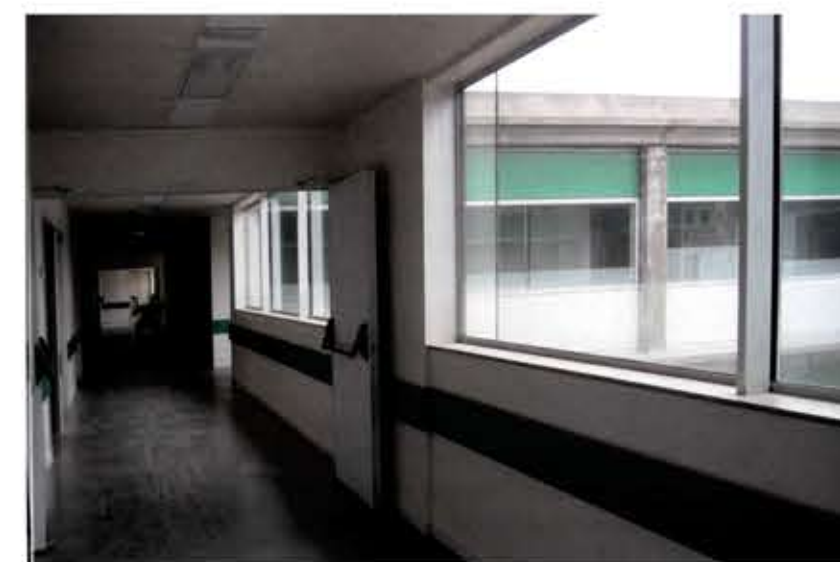
Portes de sectorització contra incendis, Hospital Infanta Leonor, Madrid, 2008 Arq. Ramon Araujo, Arturo Berned y Luis Vidal
