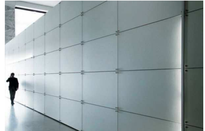
Fig. AN.07 Aplicación arquitectónica de vidrio satinado, tipo DecoFlour Mirror de OmniDecor.
