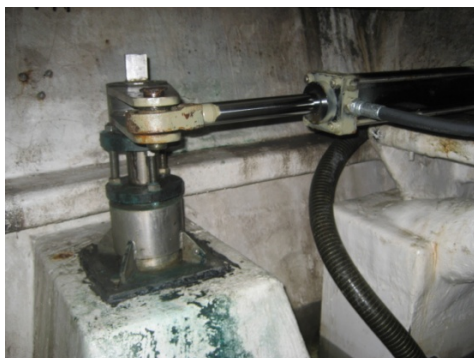
Fig.10. Fotografía servotimón estribor.
