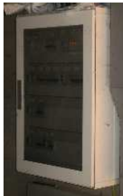
Figura 7. Quadre elèctric de la finca. (pròpia)
