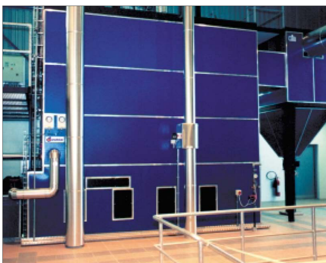
* Caldera Industrial de Cogeneració
