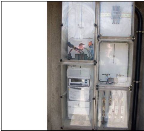
Fig 10 En el quadre de comptadors no es disposa de protecció diferencial.
