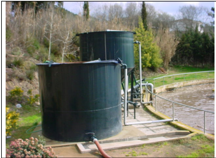
Fig 5. El fangs de la decantació secundària s'envien als dipòsits concentrador de fangs on part es recircula cap al reactor biològic i part cap el dipòsit tampó.
