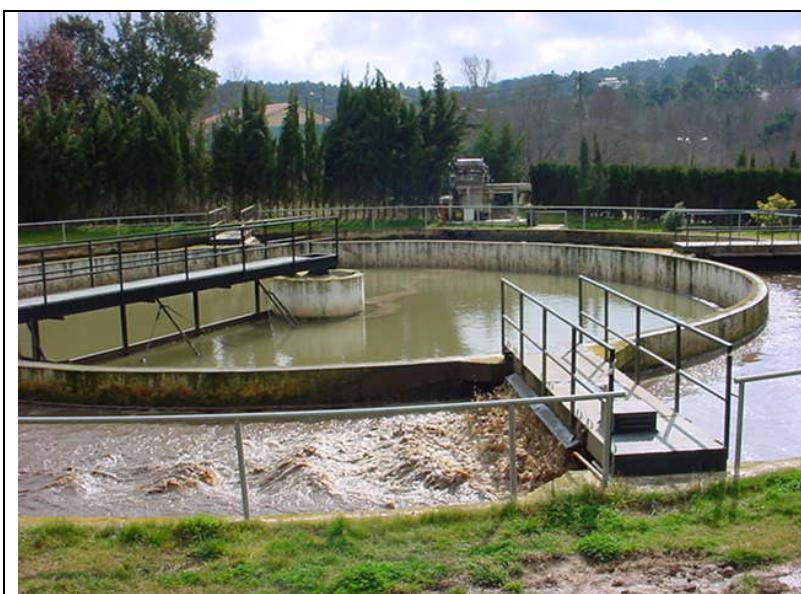
Fig 4. L'aigua tamisada del pou de bombament arriba al reactor biològic (part exterior) on se li aporta aire mitjançant rotors d'aireació superficial i es recircula el fang extret de la decantació secundària (part interior).
