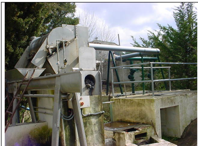
Fig 3. Detall del pou de bombament, aquí arriba l'aigua bruta per gravetat dels col·lectors de l'urbanització i es bombeja cap al rototamís que desbasta l'aigua. La part sòlida va cap al cargol premsa i l'aigua tamisada va cap al reactor biològic.
