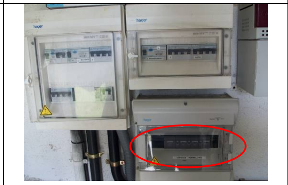
Fig 9. La instal·lació només disposa de tres diferencials, un per a les 2 bombes d'entrada, un altre per al tres rotors i un altre per al la il·luminació i força. També disposa l'EDAR de proteccions per a sobretensions transitòries.
