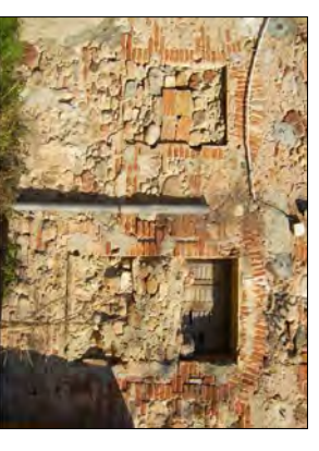
Trencament en les instal·lacions d'evacuació d'aigua de la coberta.
