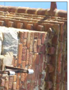
Corrosió d'elements metàl·lics encastats a la paret.
