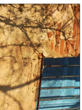
Corrosió d'elements metàl·lics encastats a les parets.
