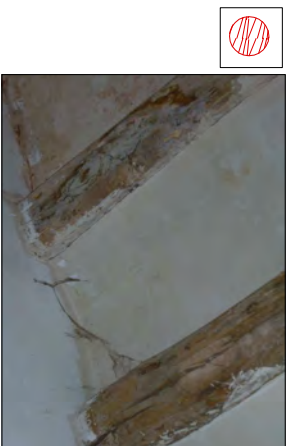
Fongs de podriment en la biga 12 sala central Planta Sotacoberta.
