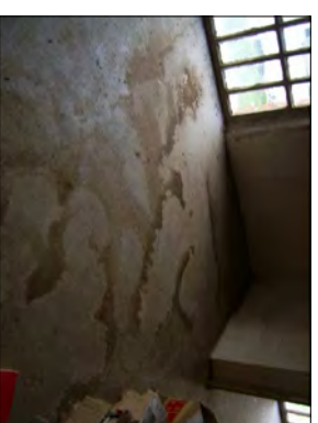
Taques de rentat diferencial que evidencien la filtració d'aigua a través de la coberta.
