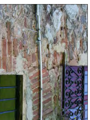
Fissures verticals entre els arcs de càrrega de les finestres.
