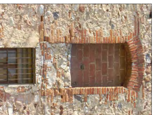
Disminució de secció important en tota part central de la façana est.
