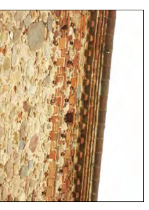
Forats en la façana de dimensions importants
