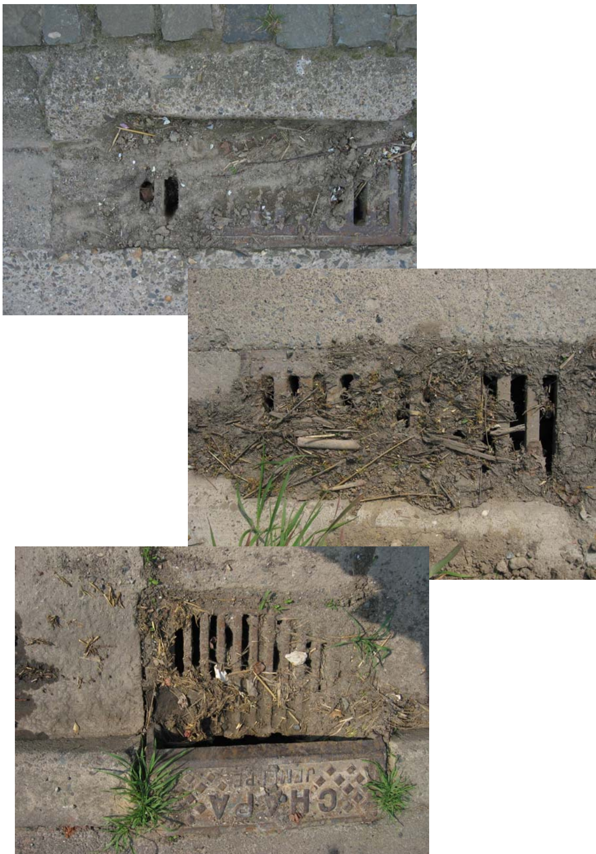
Exemple d'avaloirs en mauvais état à Villers
