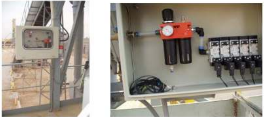
Figura. 14. Cuadro neumático Fuente: Elaboración propia
