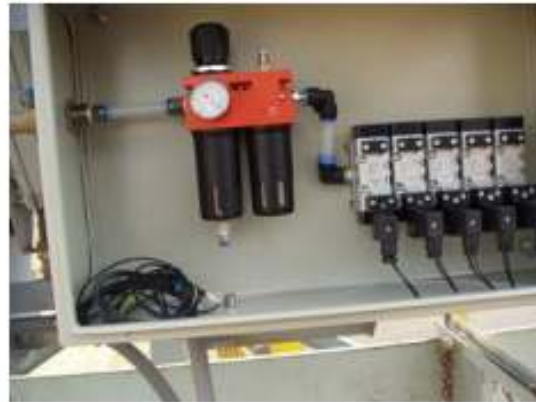
Figura. 22. Cuadro neumático Fuente: Elaboración propia
