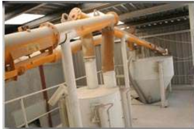
Figura. 11. Básculas de cemento Fuente: Elaboración propia
