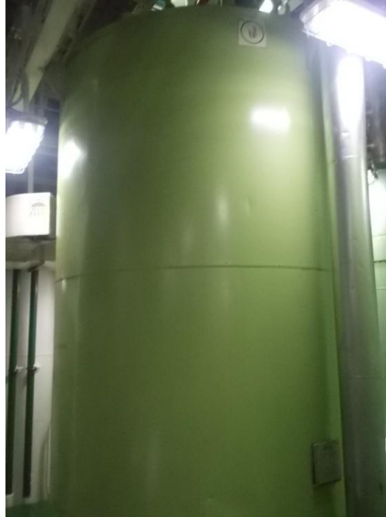
Ilustración 36 Caldera de la sala de máquina para calentar el aceite térmico
