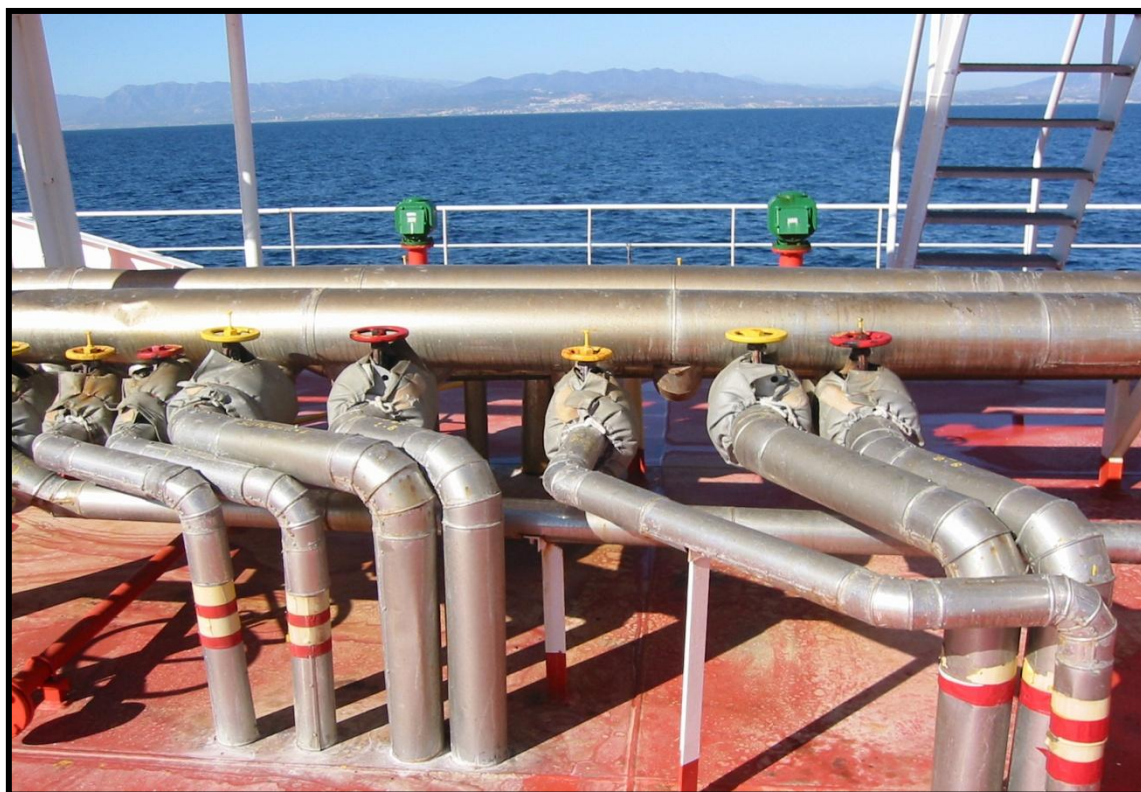
Ilustración 12 Serpentes de calefacción de los tanques operados desde la cubierta principal
