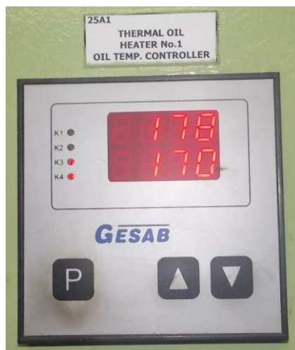
Ilustración 37 Display de las calderas para seleccionar la temperatura del aceite térmico
