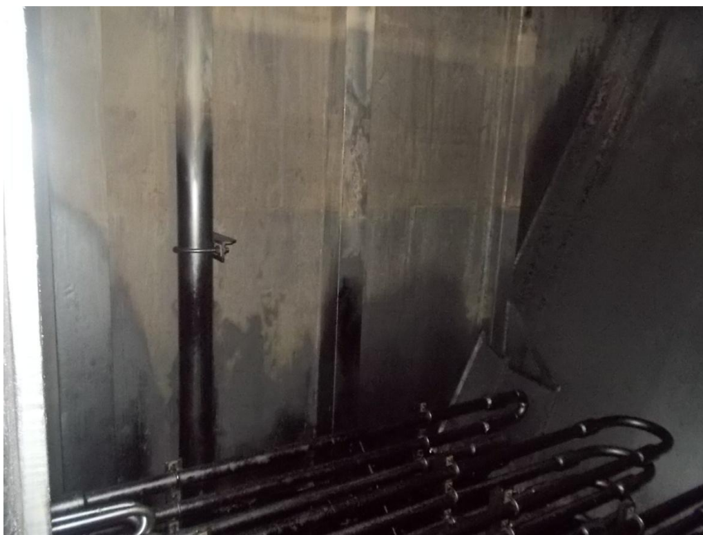
Ilustración 8 Serpentes de calefacción de los tanques de carga
