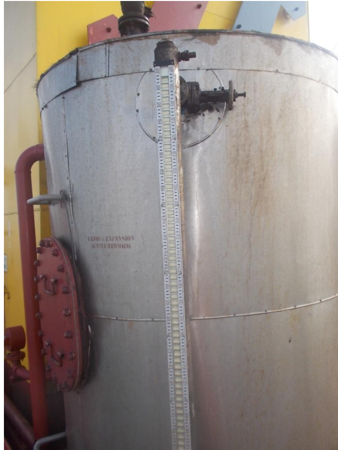
Ilustración 38 Tanque de expansión del aceite térmico situado en la cubierta puente
