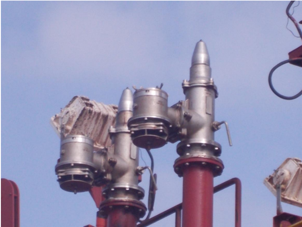
Ilustración 21 Válvula Presión/Vacío tanques de carga
