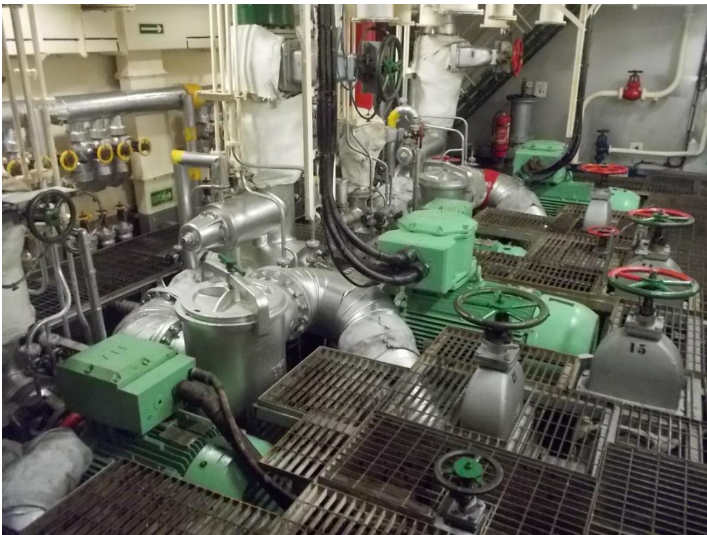
Ilustración 4 Cuarto de bombas de un buque asfaltero
