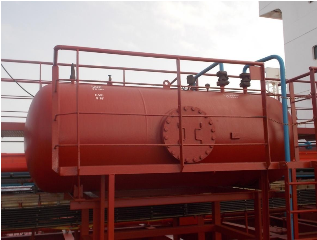
Ilustración 31 Botella del 'padding' situada en la cubierta principal
