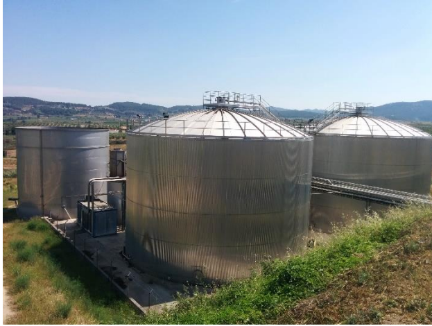
Tanc homogeneïtzador d'emmagatzematge i reactors anaeròbics
