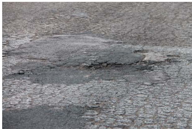
Fig. 3.39. Ejemplo de desprendimiento en un pavimento flexible.
