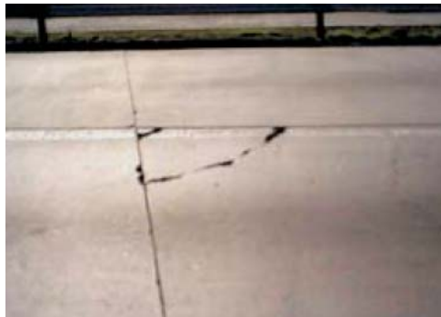
Fig. 3.45. Ejemplo de grieta de esquina en pavimento rígido 113 .
