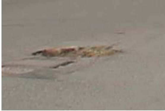
Fig. 3.42. Ejemplo de bache profundo en un pavimento flexible. Fuente propia.
