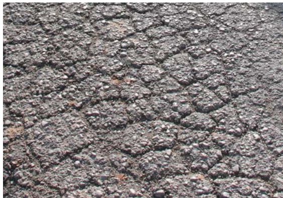
Fig. 3.43. Ejemplo de piel de cocodrilo en un pavimento flexible. Fuente propia.
