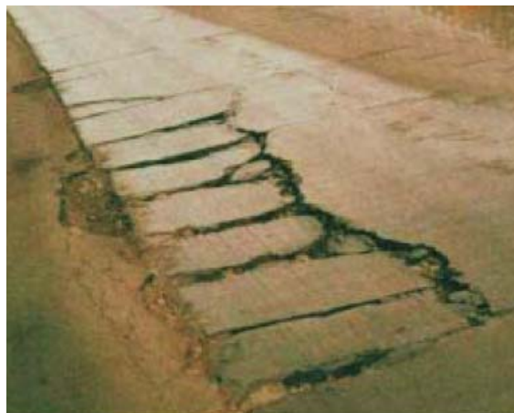
Fig. 3.47. Ejemplo de fracturación múltiple en pavimento rígido 115 .
