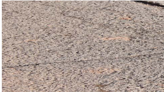
Fig. 3.40. Ejemplo de alisamientos en un pavimento flexible. Fuente propia.
