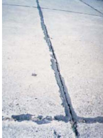
Fig. 3.44. Ejemplo deficiencias de sellado en pavimento rígido 112 .
