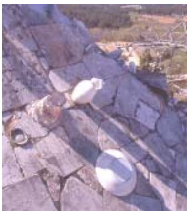
Objetos desplazados en la cubierta de la torre.
