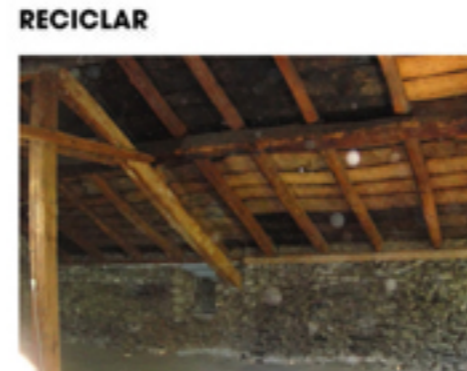
BIGUES I BIGUETES DE FUSTA DE COBERTA EN BON ESTAT GRÀCIES A LA BONA VENTILACIÓ A LA QUE HA ESTAT EXPOSADA. NO HA PATIT L'ATAÇ DE CORCS. TAMPOC ES PERCEBEN EXCESSIVES DEFORMACIONS
