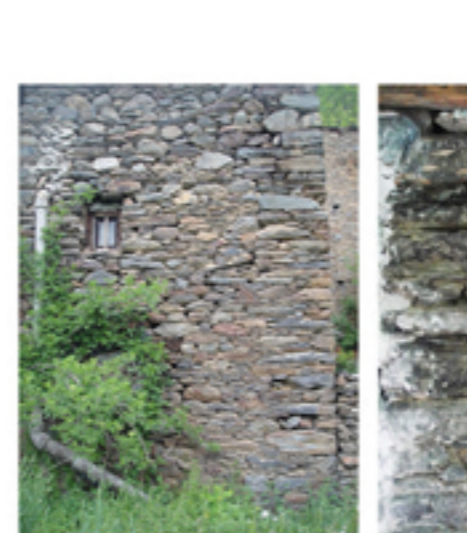
ENVOLVENT DE MURS DE PEDRA EN SEC ESTRUCTURALMENT ESTABLE. PATEIX HUMITATS A LES ZONES ON TÉ CONTACTE DIRECTE AMB EL TERRENY. PRESENTA IMPERFECCIONS DES DE LA SEVA CONSTRUCCIÓ FORMANT CAVITATS QUE SERVEIXEN DE NIU PER A PETITS ANIMALONS I PROVOCAN UNA DEFICIÈNCIA EN L'ALLAMENT DE L'EDIFICI.
