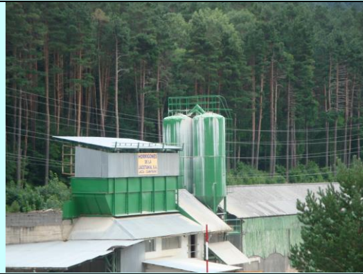
20, 21, 23 PLANTA DE TRATAMIENTO
