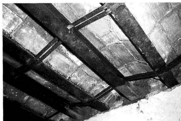
Foto 7.—La adaptación del sistema de viga bajo viga por problemas de altura libre, se puede resolver de diferentes formas.
