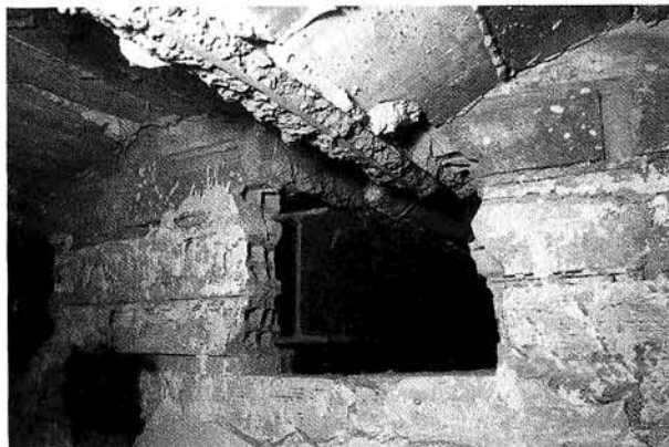
Foto 6.—El sistema de viga bajo viga parece que sigue siendo la mejor solución también en las viguetas fabricadas con cemento aluminoso.
