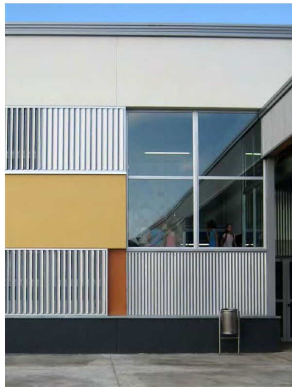
PANEL·L DE FORMIGÓ PREFABRICAT PER A FAÇANA XAPA METÀLLICA MINIONA, FUSTERIA D'ALUMINI
