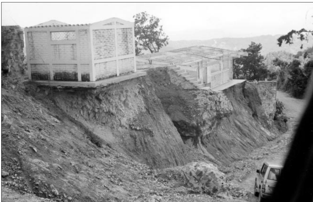
• Escola en construcció que va ser afectada per una de les esllavissades produïdes pel Mitch
