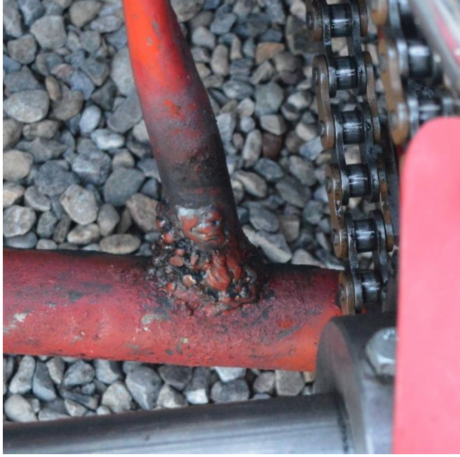
19: Exemple de soldadura incorrecta (Font: Foto pròpia)
