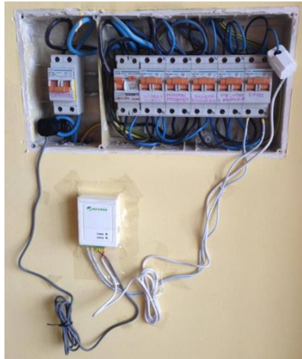
Figura 35. Instalación del monitor de energía en la micro-red. Instalación propia del autor.
