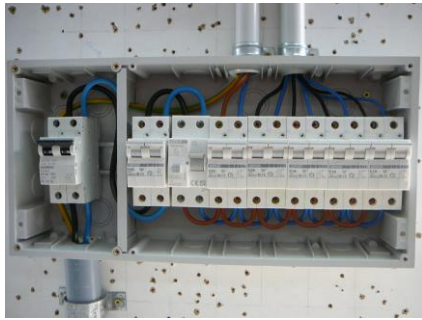
Fig.2: Cuadro General de Mando y Protección
