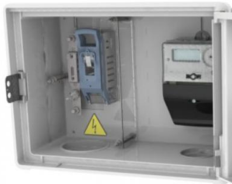
Imagen 2: Caja General de Protección y de Medida
