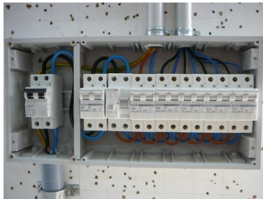
Imagen 4: Cuadro general de mando y protección
