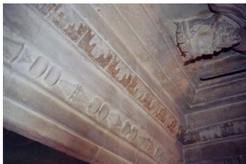
Figura 9. Restos de dorado con pan de oro, bol rojo y colores verde y azul en la moldura del nervio. Restos de dorado con pan de oro en la corona y la espada del rey. Se observa la veladura original de consolidación, protección y entonación cromática
