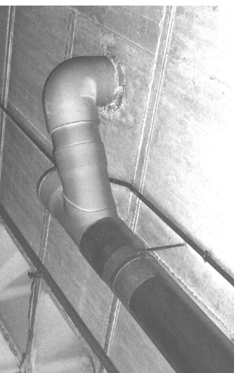
Canonades de polipropil·len penjades a forjats - coizes de baixants registrables i reforçats amb brides.
