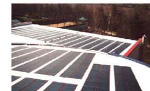
PLACAS SOLARES FOTOVOLTAICAS EN CUBIERTA
