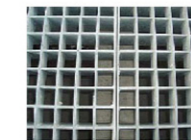
REJILLA DE VENTILACIÓN ENTRE PLANTAS
