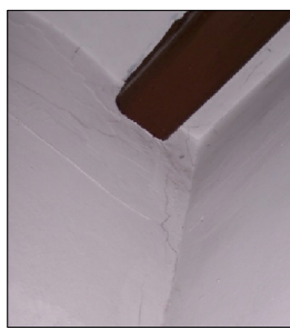
FITXA Nº11: Fissura
