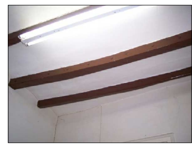
FITXA Nº18: Fletxa excessiva
