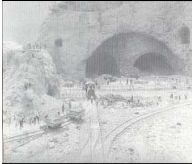
Foto 10: Vista de las obras en la zona donde estarán ubicadas las compuertas. En esta foto se puede ver la locomotora a la que hacíamos referencia anteriormente.
