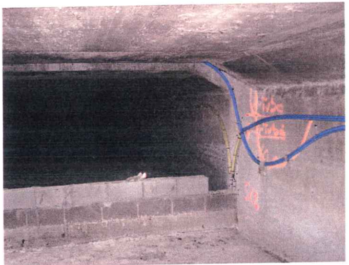
Foto (8) sondas conductivas instaladas
