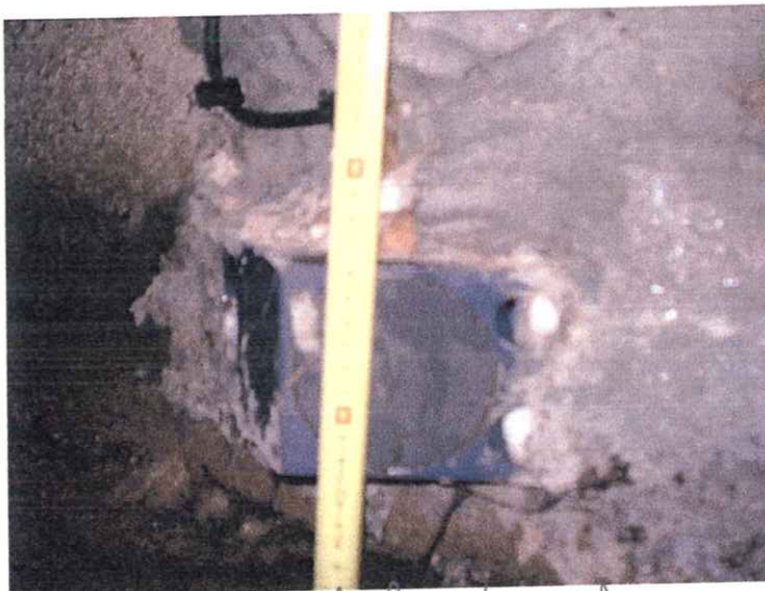
Foto 11 caudalímetro inferior Mirando al mar lado derecho 12 cm. desde solera a eje del Sensor.
