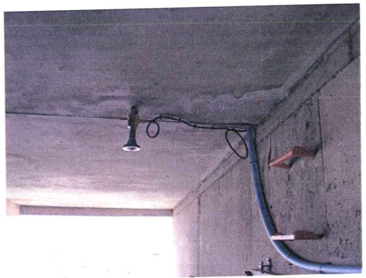
Foto (16) Linnímetro L-192 colgado del techo del colector (No tiene pozo)
