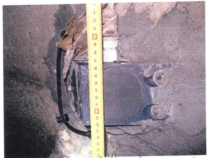
Foto 12 caudalímetro Superior Mirando al mar lado derecho 32 cm. desde solera al eje del Sensor.
