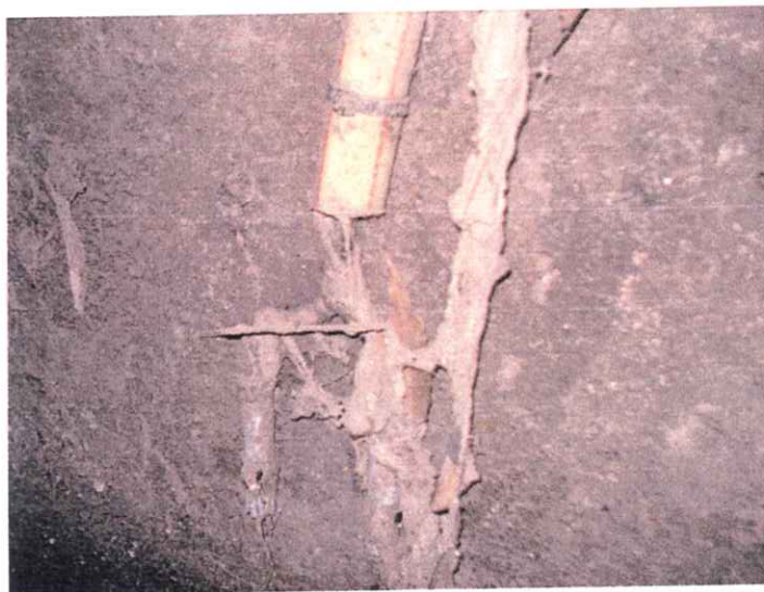
Foto ④ SC-1 sonda conductiva con sedimento pegado de trapos y papeles
