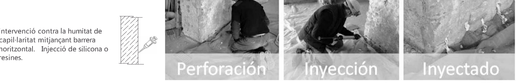
intervenció contra la humitat de capil·laritat mitjançant barrera horitzontal. Injecció de silicona o resines.
