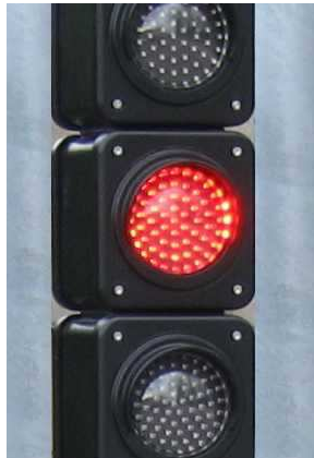
Fig. 59 Aspecto rojo luciendo en señal foco LED LD-120-P de ELECTRANS.
