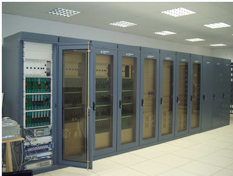
Fig. 63 Enclavamiento electrónico WESTRACE de DIMETRONIC.
