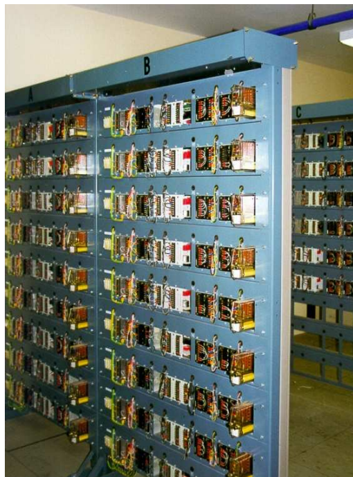
Fig. 74 Bastidor con CVSJ FS5000 en sala de enclavamiento de Clot L2.
