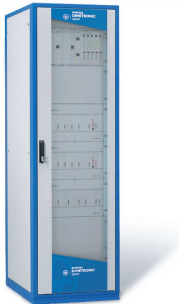
Fig. 79 Enclavamiento electrónico WESTRACE de DIMETRONIC.
