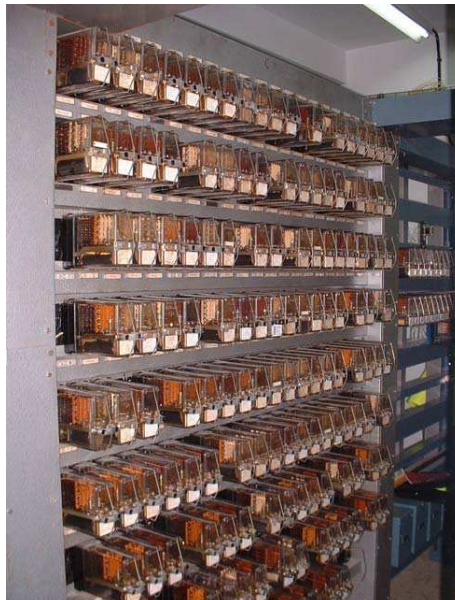
Fig. 61 enclavamiento eléctrico de cableado libre.
