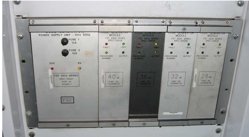
Fig. 25 Fuente de alimentación y Generadores de ATP FST2500 en Paseo de Gracia L2.
