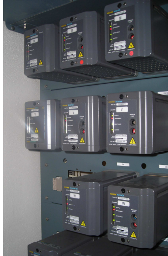
Fig. 73 Detalle del bastidor de CVSJ FS2550 5k en sala de enclavamiento de Clot L2.
