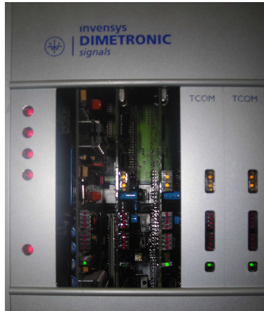
Fig. 75 Tarjetas TCOM en sala de enclavamiento de Clot L2.
