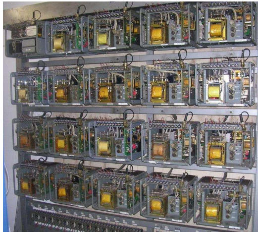
Fig. 68 Bastidor con Transmisores de ATP en sala de enclavamiento de La Pau L4.
