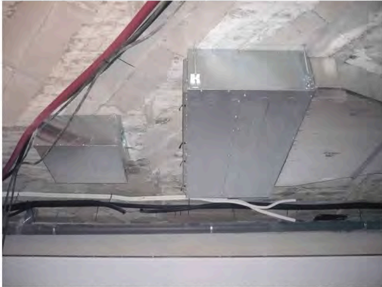
Exemple de col·locació de fancoil (dreta) amb sistema de captació i tractament d'aire exterior (esquerra)
