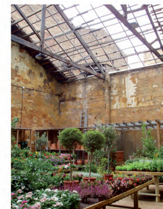
Interior Nau interior, on es veu la desaparició de la coberta.
