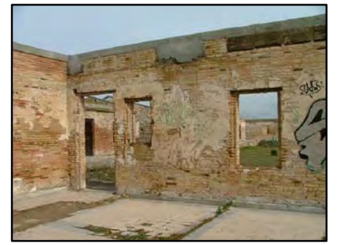
F-5 MANCHAS Y EFLORESCENCIAS EN FACHADA: En los zócalos las manchas y eflorescencias tienen su inicio en la humedad por capilaridad. FF-5
