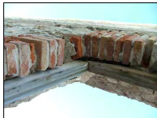
F - 5 FCA - 7 CARPINTERÍA EXTERIOR: Putrefacción de la carpintería de madera, causada por la presencia de humedad y falta de mantenimiento.
