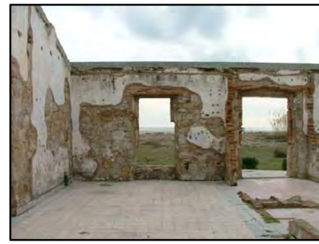
F-4 DESPRENDIMIENTOS EN FACHADA: Del mortero de cal, producida por una falta de adherencia entre el revestimiento y el soporte, que puede ser causada por la presencia de sales, un defecto de ejecución, etc. FF-4
