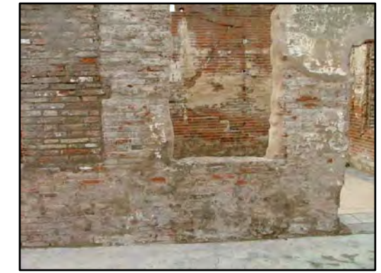
F-5 FF-5 MANCHAS Y EFLORESCENCIAS EN FACHADA: En los zócalos las manchas y eflorescencias tienen su inicio en la humedad por capilaridad. Las fachadas norte y este, están muy manchadas debido a la sombra y humedad que se genera en éstas.
