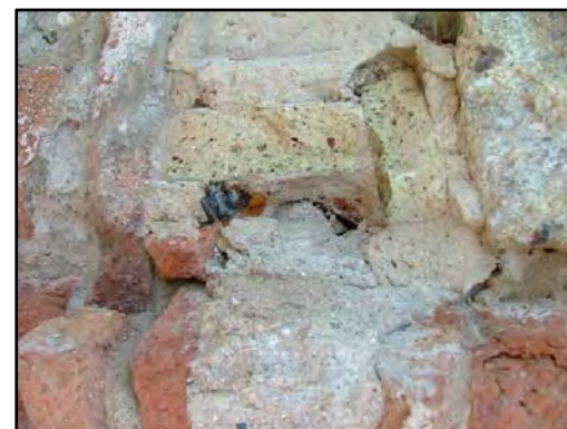
F - 6 FCA - 8 CORROSIÓN DE ANCLAJES PARA VENTANAS Y PUERTAS: Oxidación y corrosión progresiva de los anclajes provocan la meteorización del soporte.
