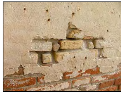
F-3 EROSIÓN EN FACHADA: Abrasión o desgaste superficial producido por la lluvia y el viento. Provocan pérdida de sección y originan una pérdida de capacidad portante. FF-3
