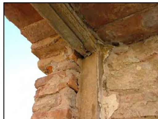
F-7 FCA-7 CARPINTERÍA EXTERIOR: Putrefacción de la carpintería de madera, causada por la presencia de humedad y falta de mantenimiento.
