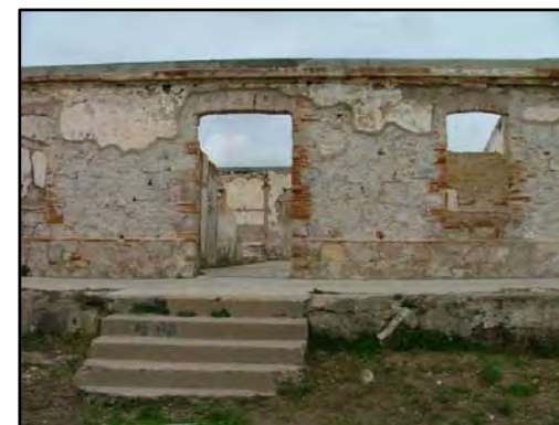
F - 9 FCU - 11 CUBIERTAS: Totalmente desaparecidas, provocado por la falta de mantenimiento en un ambiente marino y al abandono del cuartel. Ha incrementado las patologías afectando gravemente a la cubierta y a las piezas estructurales.
