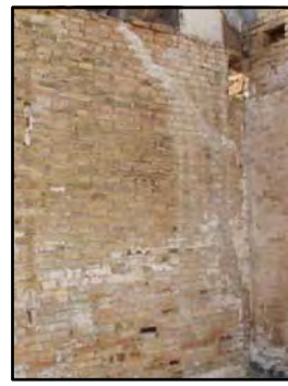
F-2 FISURAS Y GRIETAS EN FACHADA: Producidas por acciones mecánicas de origen estructural, como pueden ser los asentamientos, etc. FF-2
