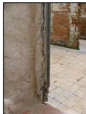
F-6 FCA-7 CARPINTERÍA EXTERIOR: Putrefacción de la carpintería de madera, causada por la presencia de humedad y falta de mantenimiento.
