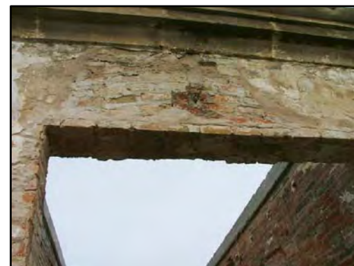
F-7 FCA-8 CORROSIÓN DE ANCLAJES PARA VENTANAS Y PUERTAS: Oxidación y corrosión progresiva de los anclajes provocan la meteorización del soporte.
