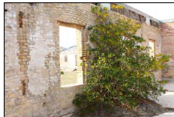
F-8 FCA-8 CORROSIÓN DE ANCLAJES PARA VENTANAS Y PUERTAS: Oxidación y corrosión progresiva de los anclajes provocan la meteorización del soporte.
