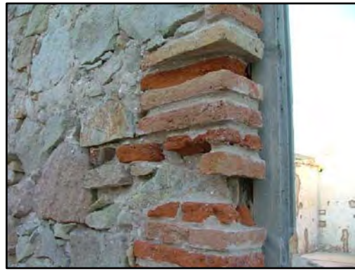
F - 3 FF - 3 EROSIÓN EN FACHADA: Abrasión o desgaste superficial producido por la lluvia y el viento. Provocan pérdida de sección y originan una pérdida de capacidad portante.
