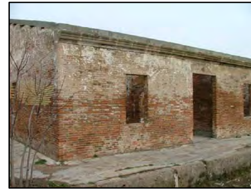
F-4 FF-4 DESPRENDIMIENTOS EN FACHADA: Del mortero de cal, producida por una falta de adherencia entre el revestimiento y el soporte, que puede ser causada por la presencia de sales, un defecto de ejecución o la degradación del material de soporte.
