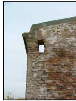
F-2 FF-2 FISURAS Y GRIETAS EN FACHADA: Producidas por acciones mecánicas de origen estructural, como pueden ser los asentamientos y los desplazamientos de los cimientos, flechas de vigas y techos.
