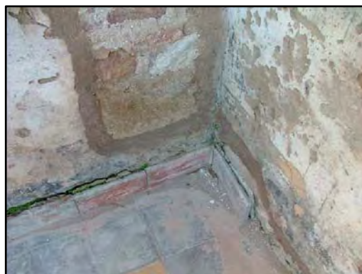
F-6 FEV-6 DESPRENDIMIENTOS DE ZÓCALOS INTERIORES: La presencia de humedad provoca la pérdida de adherencia del enfoscado, causando el desprendimiento del zócalo.
