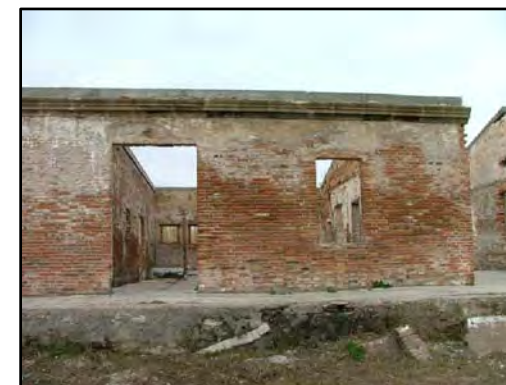
F-8 FCU-11 CUBIERTAS: Totalmente desaparecidas, provocado por la falta de mantenimiento en un ambiente marino y al abandono del cuartel. Ha incrementado las patologías afectando gravemente a la cubierta y a las piezas estructurales.
