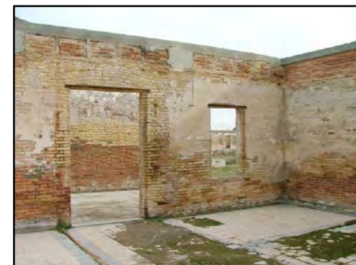
F-9 FCU-11 CUBIERTAS: Totalmente desaparecidas, provocado por la falta de mantenimiento en un ambiente marino y al abandono del cuartel. Ha incrementado las patologías afectando gravemente a la cubierta y a las piezas estructurales.
