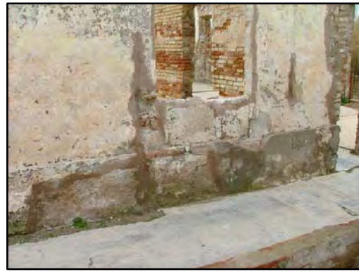
F - 1 FF - 1 HUMEDADES POR CAPILARIDAD EN FACHADA: Afectan a las zonas bajas de la fachada aproximadamente entre 0,50 y 1 m. de altura. Descomposición y degradación progresiva de la pared.
