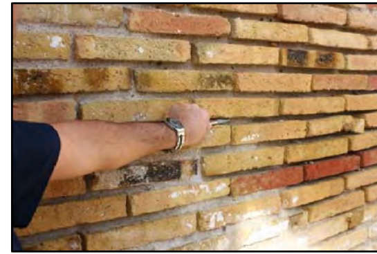
F-3 FF-3 EROSIÓN EN FACHADA: Abrasión o desgaste superficial producido por la lluvia y el viento. Provocan pérdida de sección y originan una pérdida de capacidad portante.
