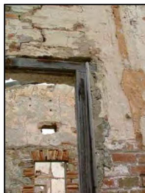
F - 6 FCA - 7 CARPINTERÍA EXTERIOR: Putrefacción de la carpintería de madera, causada por la presencia de humedad y falta de mantenimiento.
