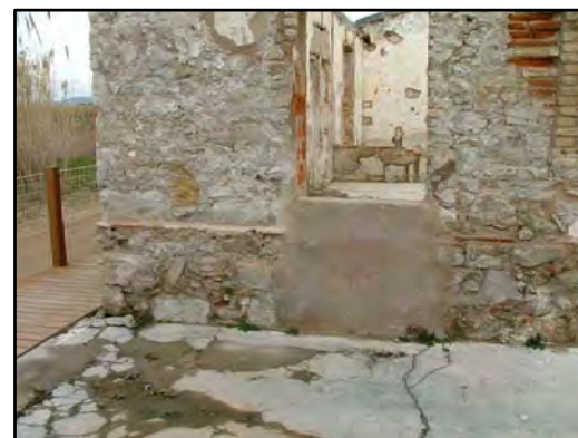
F - 8 FCI - 9 ASENTAMIENTO DIFERENCIAL LOSA DE CIMENTACIÓN: El cimiento en algunas zonas, no es capaz de absorber una deformación local del suelo causada por una variación en la humedad del mismo.
