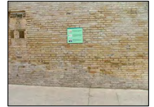
F-5 FF-5 MANCHAS Y EFLORESCENCIAS EN FACHADA: En los zócalos las manchas y eflorescencias tienen su inicio en la humedad por capilaridad. Las fachadas norte y este, están muy manchadas debido a la sombra y humedad que se genera en éstas.
