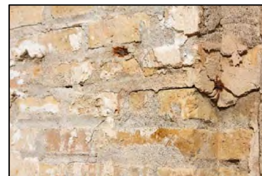
F-8 FCA-8 CORROSIÓN DE ANCLAJES PARA VENTANAS Y PUERTAS: Oxidación y corrosión progresiva de los anclajes provocan la meteorización del soporte.
