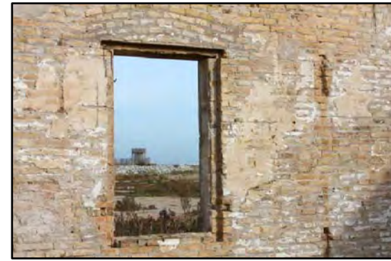
F-2 FF-2 FISURAS Y GRIETAS EN FACHADA: Producidas por acciones mecánicas de origen estructural, como pueden ser los asentamientos y los desplazamientos de los cimientos, flechas de vigas y techos.
