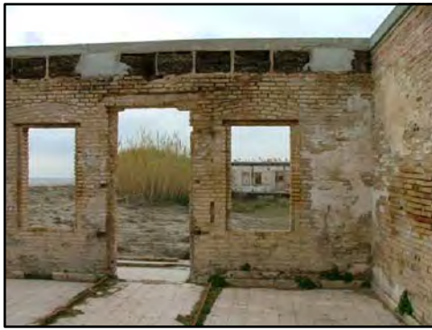
F-1 FF-1 HUMEDADES POR CAPILARIDAD EN FACHADA: Afectan a las zonas bajas de la fachada aproximadamente entre 0,50 y 1 m. de altura. Descomposición y degradación progresiva de la pared.
