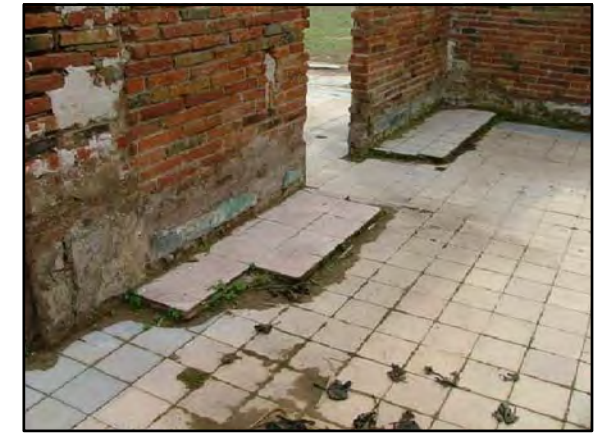
F - 5 FEV - 6 DESPRENDIMIENTOS DE ZÓCALOS INTERIORES: La presencia de humedad provoca la pérdida de adherencia del enfoscado, causando el desprendimiento del zócalo.
