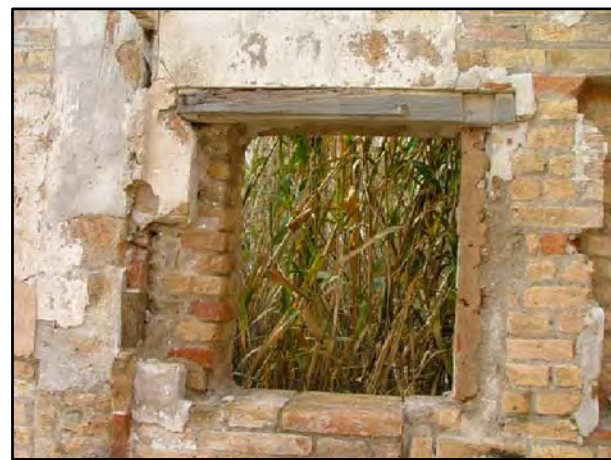
F-7 FCA-7 CARPINTERÍA EXTERIOR: Putrefacción de la carpintería de madera, causada por la presencia de humedad y falta de mantenimiento.
