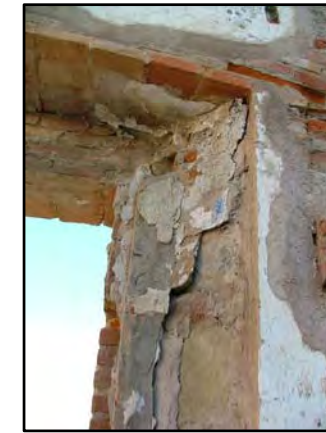
F - 4 FF - 4 DESPRENDIMIENTOS EN FACHADA: Del mortero de cal, producida por una falta de adherencia entre el revestimiento y el soporte, que puede ser causada por la presencia de sales, etc
