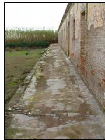
F-8 FCI-9 ASENTAMIENTO DIFERENCIAL LOSA DE CIMENTACIÓN: El cimiento no es capaz de absorber una deformación del suelo causada por una variación en la humedad del mismo.
