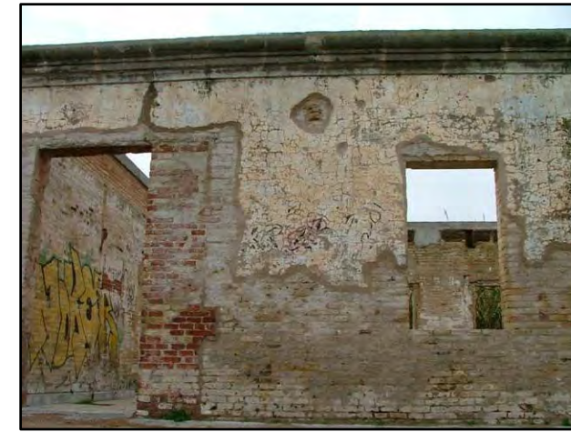
F-4 FF-4 DESPRENDIMIENTOS EN FACHADA: Del mortero de cal, producida por una falta de adherencia entre el revestimiento y el soporte, que puede ser causada por la presencia de sales, un defecto de ejecución o la degradación del material de soporte.
