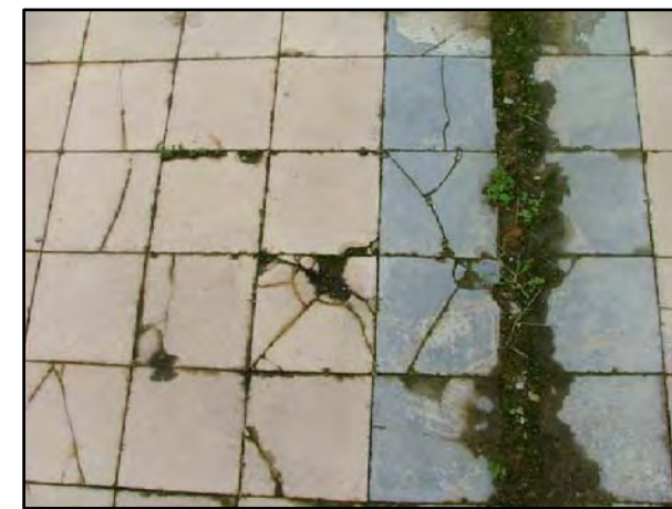
F-9 FCI-10 ABOMBAMIENTOS Y ROTURAS TÉRMICAS: Producto del gran salto térmico al que está solicitado el pavimento y a la ausencia de juntas de libre dilatación. La inexistencia de la cubierta ha incrementado tal patología.
