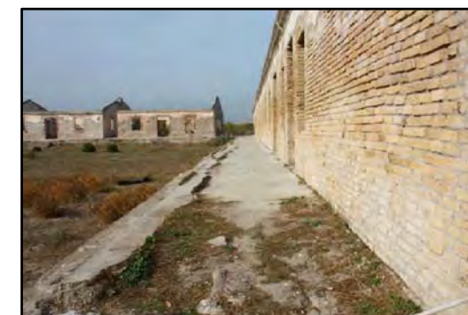
F-9 FCI-9 ASENTAMIENTO DIFERENCIAL LOSA DE CIMENTACIÓN: El cemento en algunas zonas, no es capaz de absorber una deformación local del suelo causada por una variación en la humedad del mismo.
