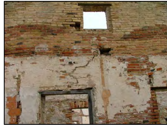
F - 2 FF - 2 FISURAS Y GRIETAS EN FACHADA: Producidas por acciones mecánicas de origen estructural, como pueden ser los asentamientos y los desplazamientos de los cimientos, flechas de vigas y techos.
