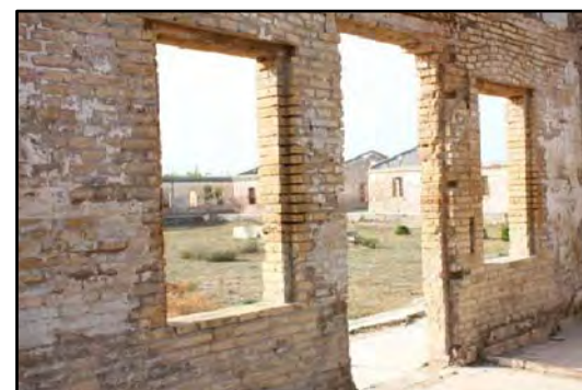
F-7 FCA-7 CARPINTERÍA EXTERIOR: Putrefacción de la carpintería de madera, causada por la presencia de humedad y falta de mantenimiento.
