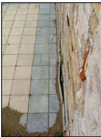
F-6 FEV-6 DESPRENDIMIENTOS DE ZÓCALOS INTERIORES: La presencia de humedad provoca la pérdida de adherencia del enfoscado, causando el desprendimiento del zócalo.
