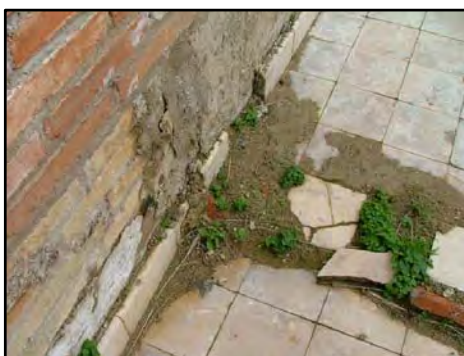
F-6 FEV-6 DESPRENDIMIENTOS DE ZÓCALOS INTERIORES: La presencia de humedad provoca la pérdida de adherencia del enfoscado, causando el desprendimiento del zócalo.
