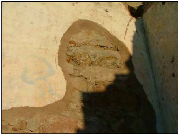
M-1 MURO DE PIEDRA ARENISCA TIPO MONTJUIC, TROZOS DE TOCHANA, ETC... ENLUCIDO CON MORTERO DE CAL
