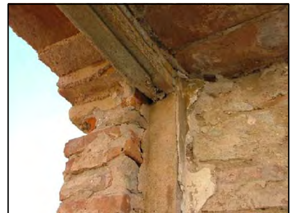
M-10 RESTOS DE LA CARPINTERÍA EXTERIOR DE MADERA
