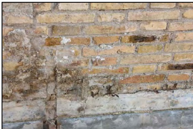
M-16 ZÓCALO CERÁMICO, DE LAS MISMAS CARACTERÍSTICAS QUE EL PAVIMENTO. HUMEDADES EN LAS PARTICIONES INTERIORES
