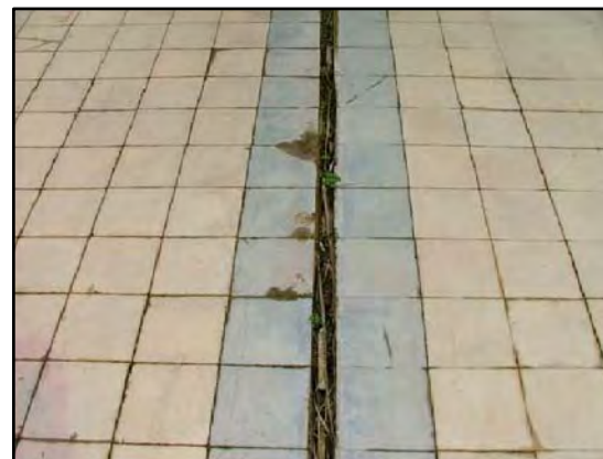
M-8 PAVIMENTO CERÁMICO DE TERRAZO DE 30 x 30 cm, DE DIFERENTES COLORES DEL INTERIOR DE LAS VIVIENDAS, Y JUNTA DE LA ANTIGUA PARTICIÓN DE DIVISIÓN DE LAS DIFERENTES ESTANCIAS
