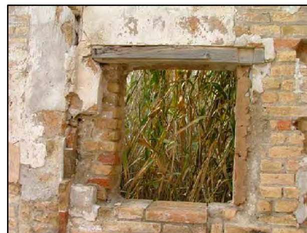
M-7 HUECO DE VENTANA, CON PEQUEÑOS RESTOS DE LA ANTIGUA CARPINTERÍA EXTERIOR DE MADERA, DE 62 x 64 cm
