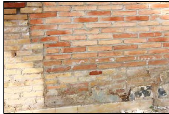
M-2 MURO DE LADRILLOS DE MEDIA ASTA ANTIGUOS Y NUEVOS DE DIVISIONES INTERIORES, ZÓCALO Y HUMEDADES DEL ALA NORTE AMBIENTE 5
