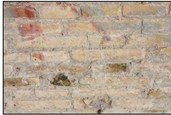
M-13 MURO DE LADRILLO DE MEDIA ASTA ENLUCIDO CON MORTERO DE CEMENTO PÓRTLAND PINTADO DE COLOR BLANCO
